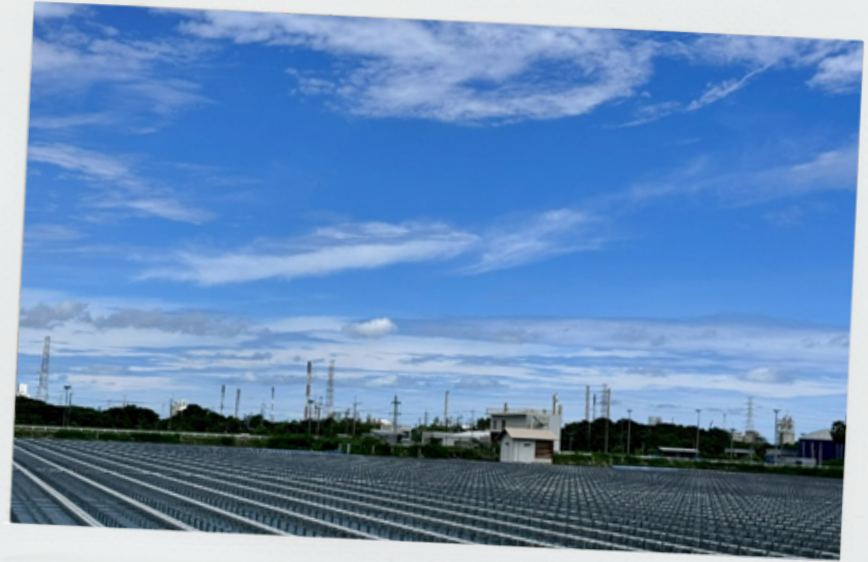
Floating Solar บริเวณบ่อหนองน้ำ 2
