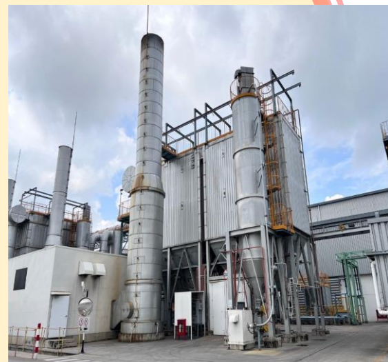
รูปที่ 5 ปล่อง Melting&holding 2 (5MF, 2-3SWF)
