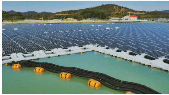
ตัวอย่างรูป การติดตั้งแผงโซลาร์เซลล์บนผิวน้ำ (Floating Solar)
