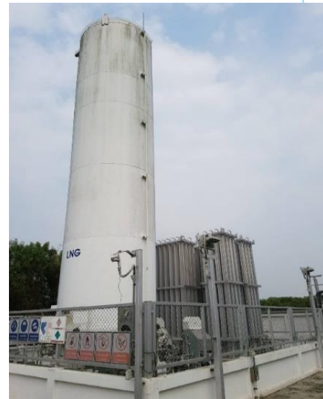
รูปที่ 7 สถานีบริการก๊าซธรรมชาติ ปตท. โพรซีชั่น ดีเวลล็อปเมนต์ จังหวัดนครปฐม
